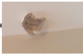
Agua percola y gotea en el techo de una casa provocando el hinchamiento del concreto.
